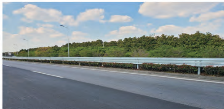
图13 提升安防建设
